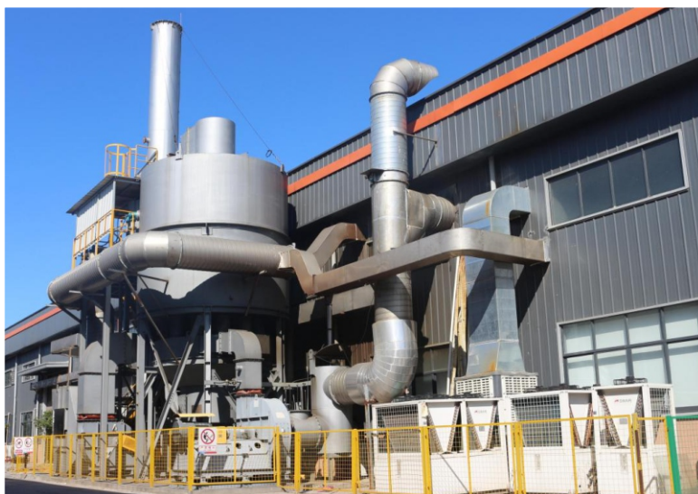
RTO余气氧化燃烧系统
